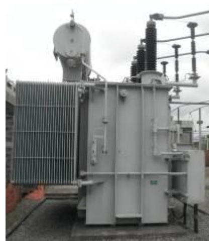
Fig. 2. SE Braskem Mauá/SP - Transformador 88 / 13,8 kV, 35 MVA
