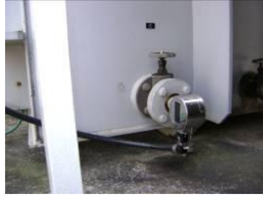
Fig. 6. Monitor de Gás e Umidade dissolvidos em óleo isolante
