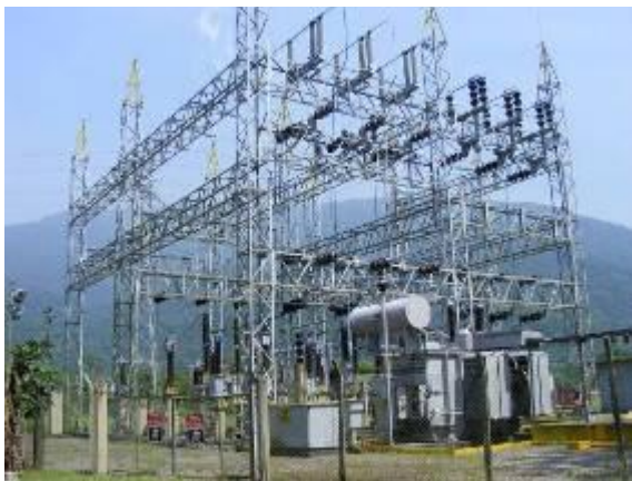
Fig. 1. SE Braskem Cubatão/SP - Transformador 88 / 13,8 kV, 15 MVA
