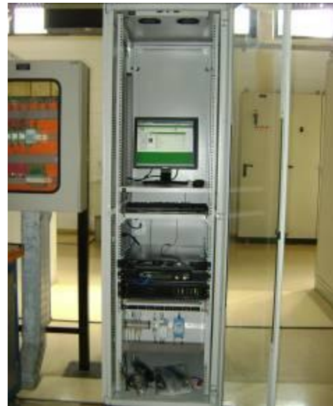
Fig. 8. Servidor com o software de monitoramento on-line na sala de controle
