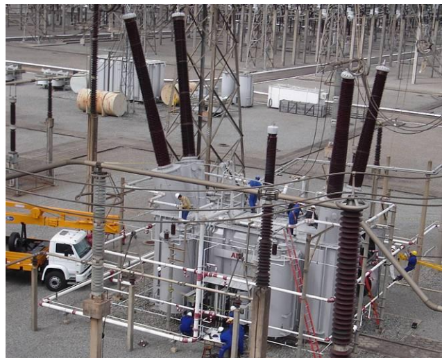
Fig. 2 – Vista geral de um transformador conversor monofásico
