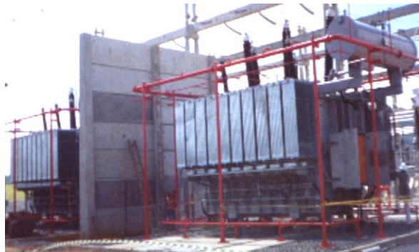
Fig. 1. Primeiros transformadores monitorados na SE Itajaí, 138/13,8 kV 150 MVA
