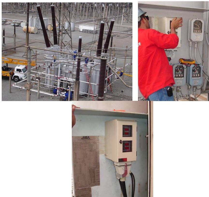
Figura 6 – Vista do transformador conversor monofásico e substituição de seus termômetros mecânicos por IEDs monitores de temperatura para o sistema de monitoração
