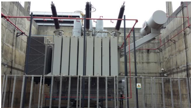
Fig. 3. Vista de uno de los transformadores elevadores, 225 MVA 18/230 kV
