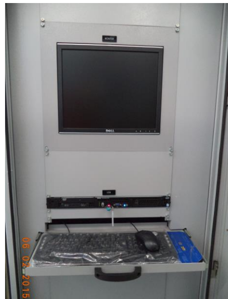
Fig. 6. Servidor de monitoreo en la sala de control
