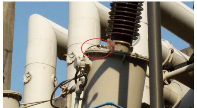
Fig. 4. Detalle de la instalación del adaptador en el tap capacitivo de los bushings de 230 kV, para monitoreo de su capacitancia y tangente delta
