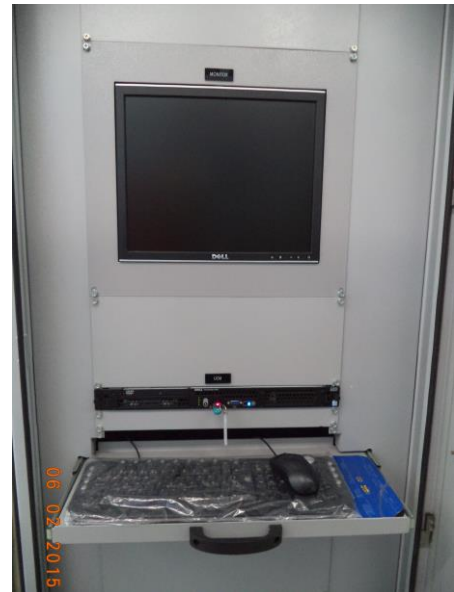
Fig. 6. Servidor de monitoramento na sala de controle
