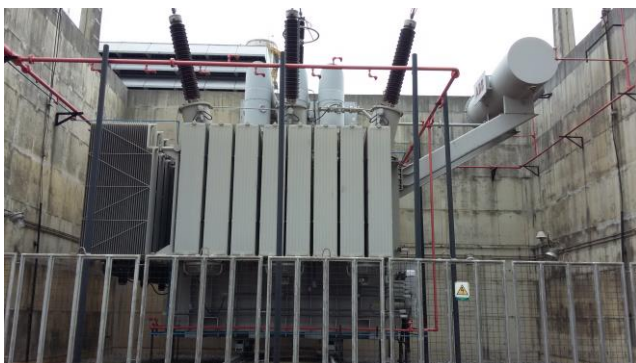
Fig. 3. Vista de um dos transformadores elevadores, 225 MVA 18/230 kV
