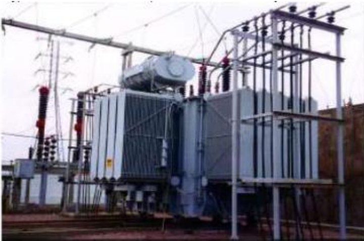
El transformador modernizado: durante cuatro años, ninguna desconexión para mantenimientos e inspecciones de rutina y seguimiento.
