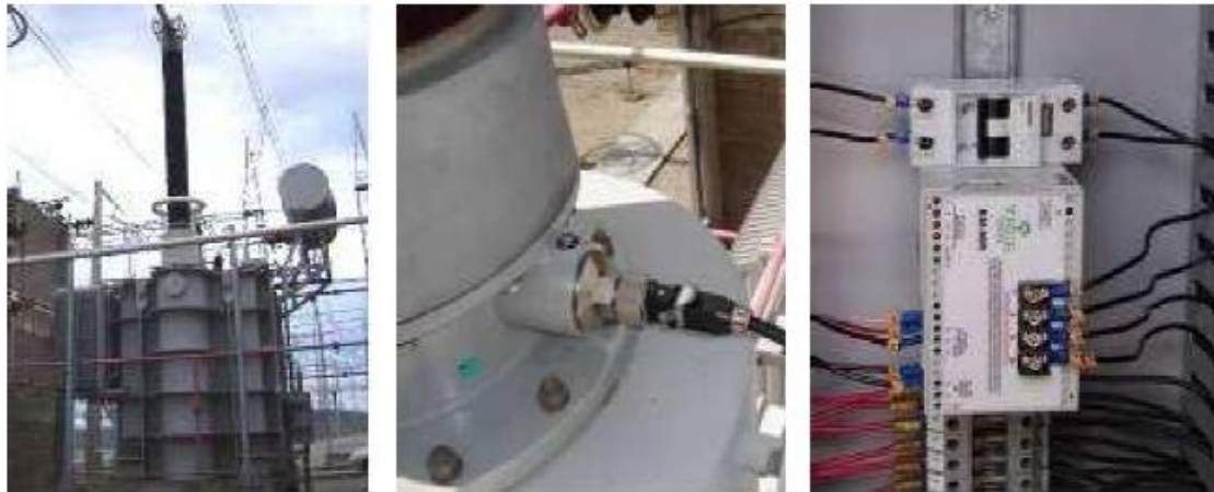
Figura 4 – Detalles del sistema para monitoreo de los bushings [3].
