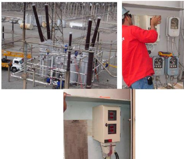
Figura 6 – Vista del transformador conversor monofásico y sustitución de sus termómetros mecánicos por IEDs monitores de temperatura para el sistema de monitoreo.
