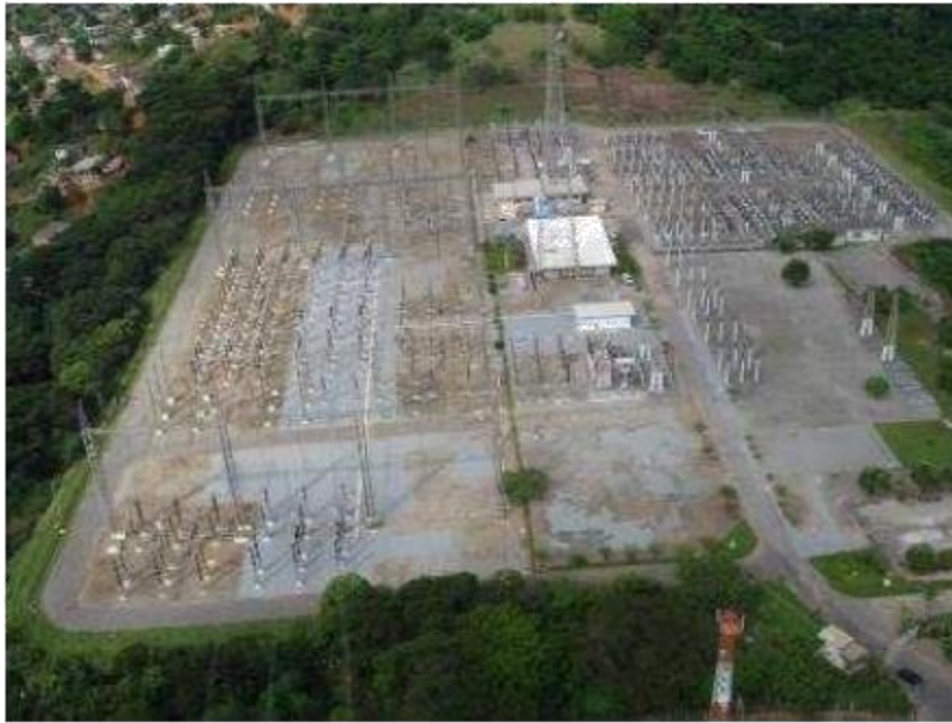
Figura 2: Vista aérea de la SE Mesquita, perteneciente a Cemig, situada en la región este de Minas Gerais.
