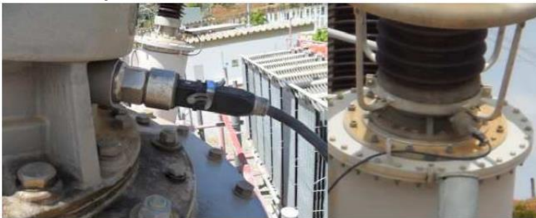
Figura 4: Detalle de los adaptadores de tap utilizados en el sistema de monitoreo de bushings BM en la SE Mesquita
