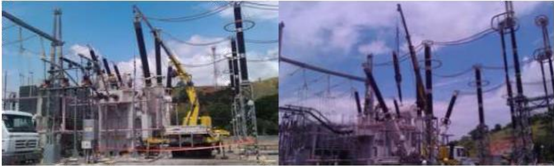
Figura 7: Equipo de Cemig realizando el cambio del bushing defectuoso.
