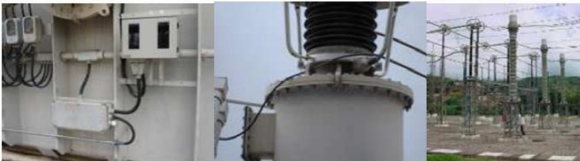
Figura 3: Detalle de las instalaciones del Sistema de Monitoreo realizadas en la SE Mesquita, de Cemig.
