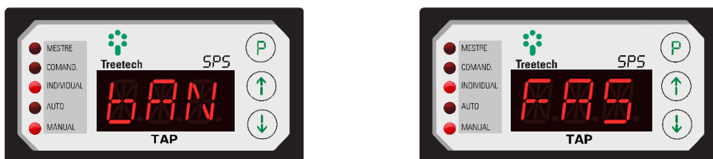
Figura 25 - Display indicando funcionamento no modo banco (BAN) ou fase individual (FAS)
