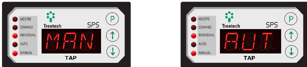
Figura 24 - Display indicando funcionamento no modo manual (MAN) ou automático (AUT)
