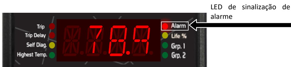
Figura 23 - Indicação de LED de sinalização de alarme
