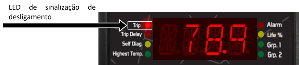
Figura 26 - LED de sinalização de desligamento
