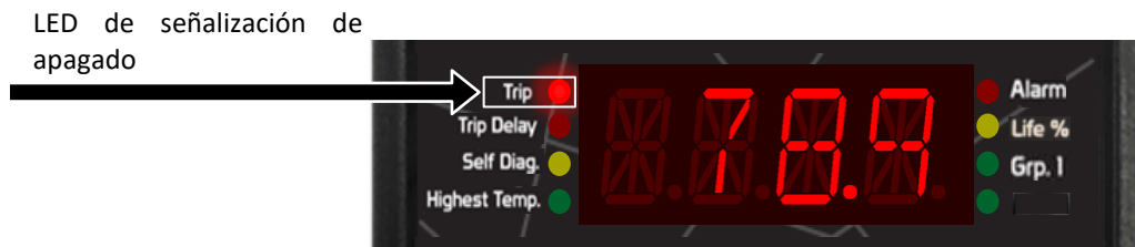
Figura 26 - LED de señalización de apagado
