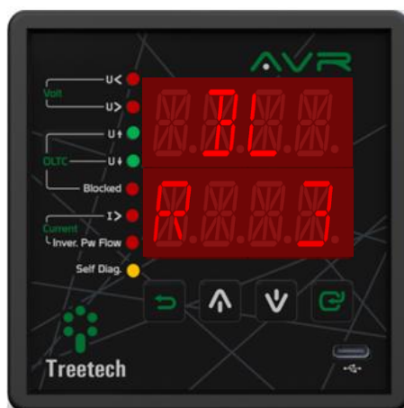
Figura 20 - Display indicando versão do release do bootloader
