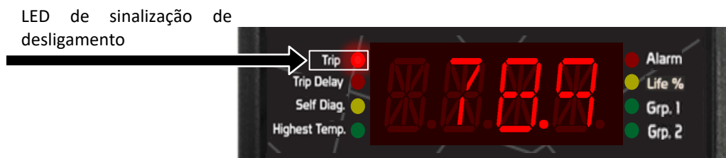
Figura 26 - LED de sinalização de desligamento
