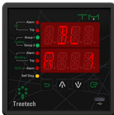
Figura 15 - Display indicando versão do release do bootloader
