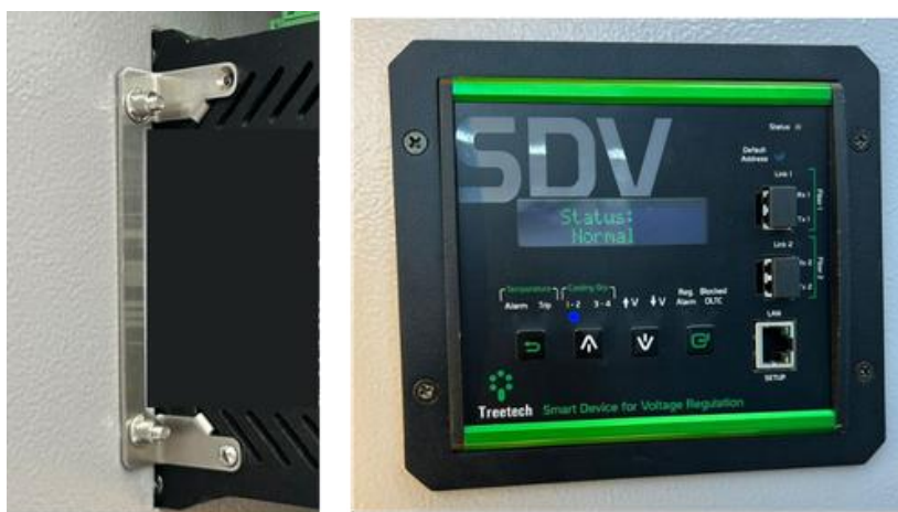
Figura 12 - Equipamento instalado no painel com travas e moldura montadas
