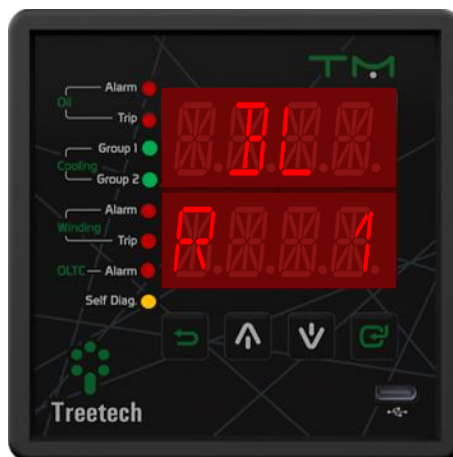
Figura 15 - Display indicando versão do release do bootloader
